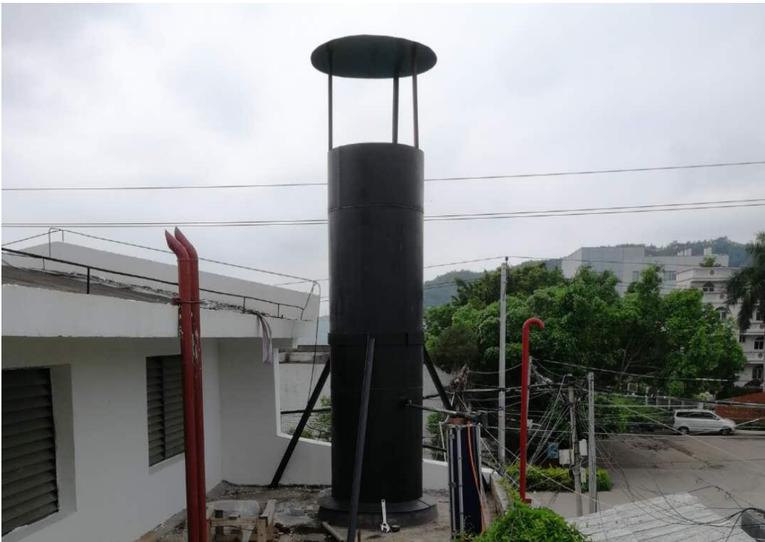
锅炉废气排放口
