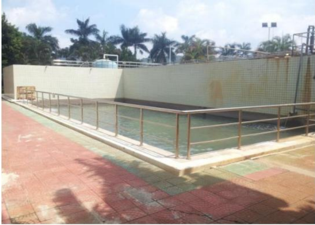
生产废水处理设施
